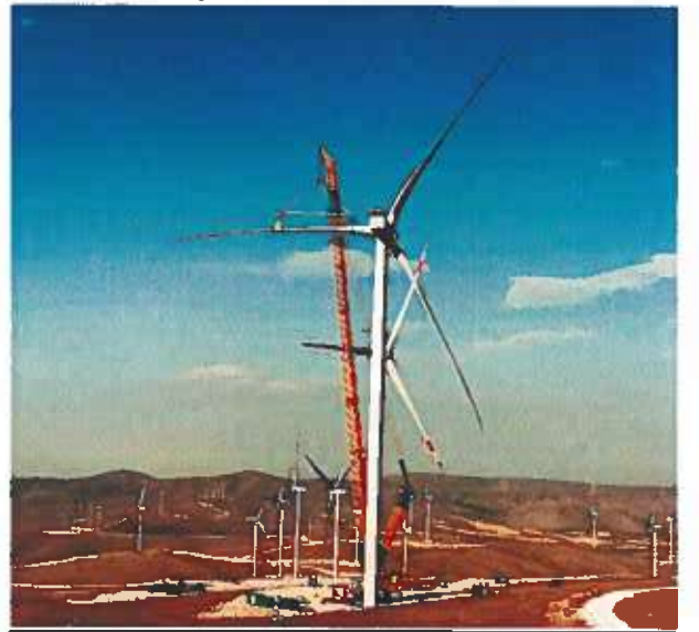
BAĞLAR RÜZGAR ENERJİ SANTRALİ PROJESİ
