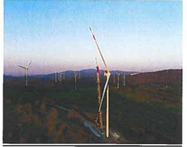
BALIKESİR ŞANLI RÜZGAR ENERJİ SANTRALİ
